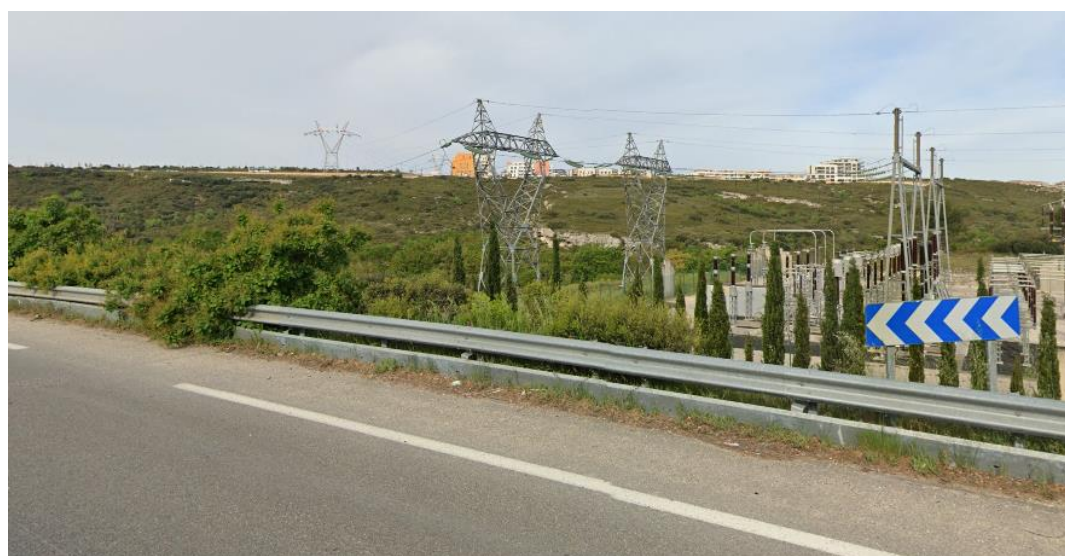
Photographie 3. Liaison « DURANNE – REALTOR » depuis le poste source 225 kV le long de la RD 9
